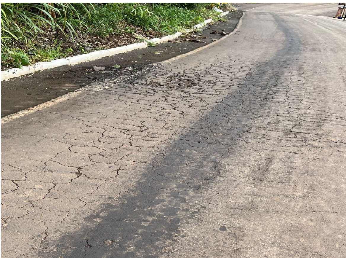
Imagem 19: 19/01/2024 – Buraco 13 Avenida João Corso Saida para São Domingos
