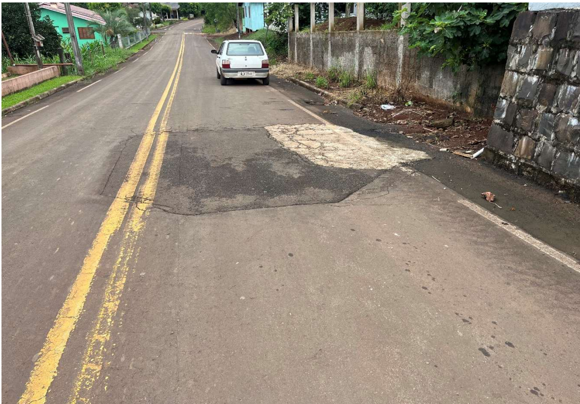
Imagem 13: 19/01/2024 – Buraco 09 Rua Beira Rio
