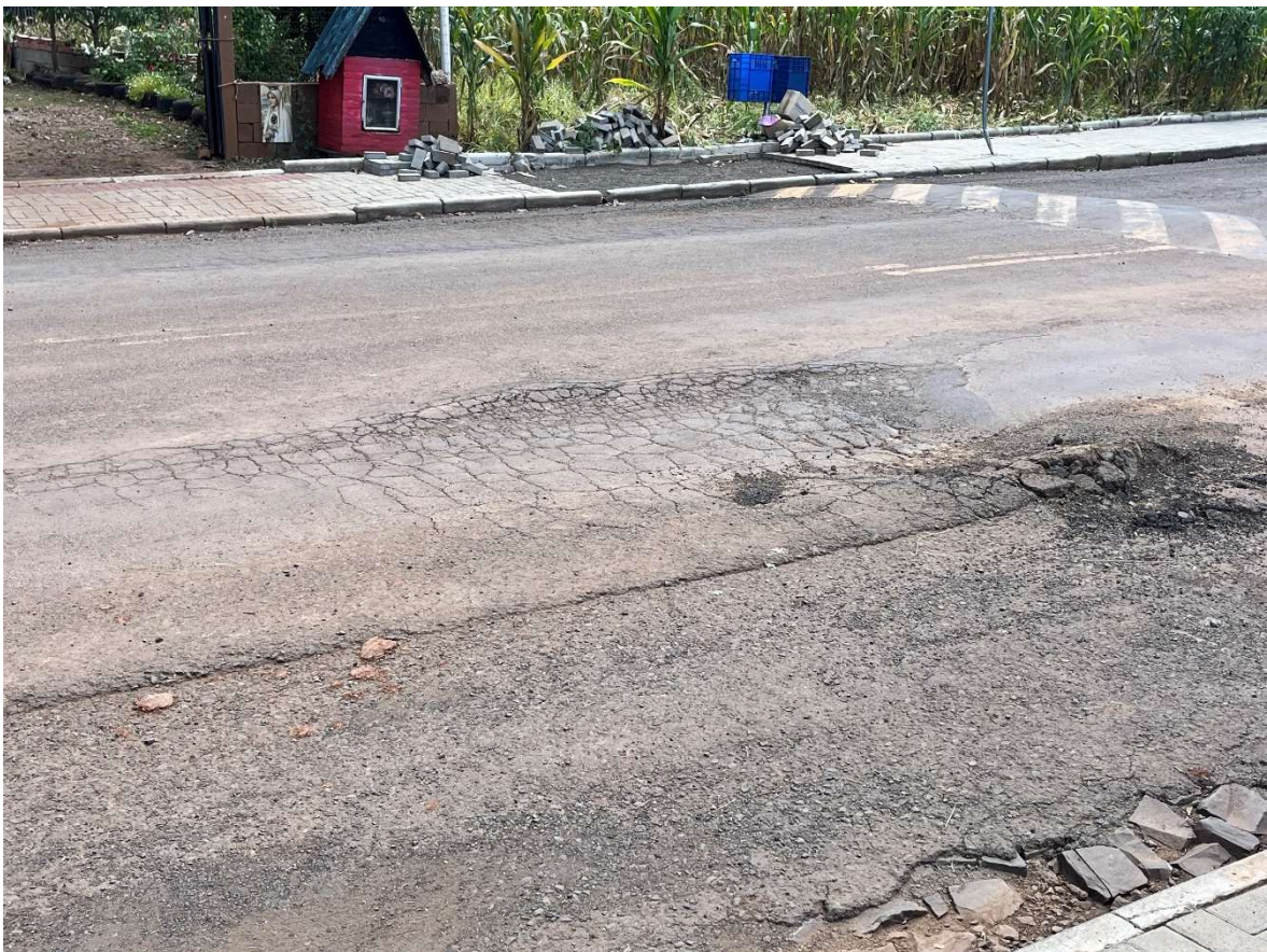
Imagem 26: 19/01/2024 – Buraco 19 Rua Ângelo Toazza
