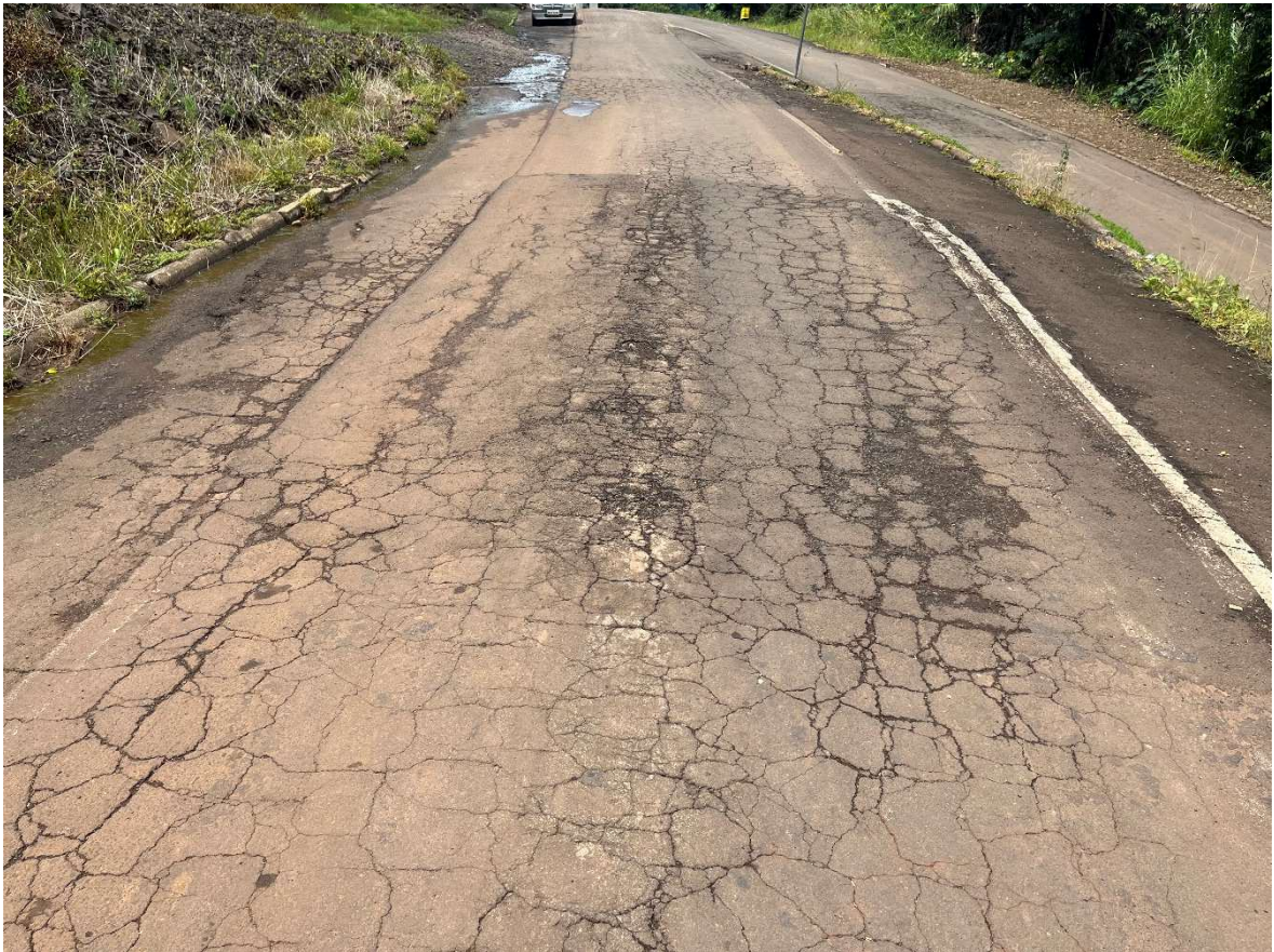
Imagem 05: 19/01/2024 – Buraco 02 Rua Beira Rio
