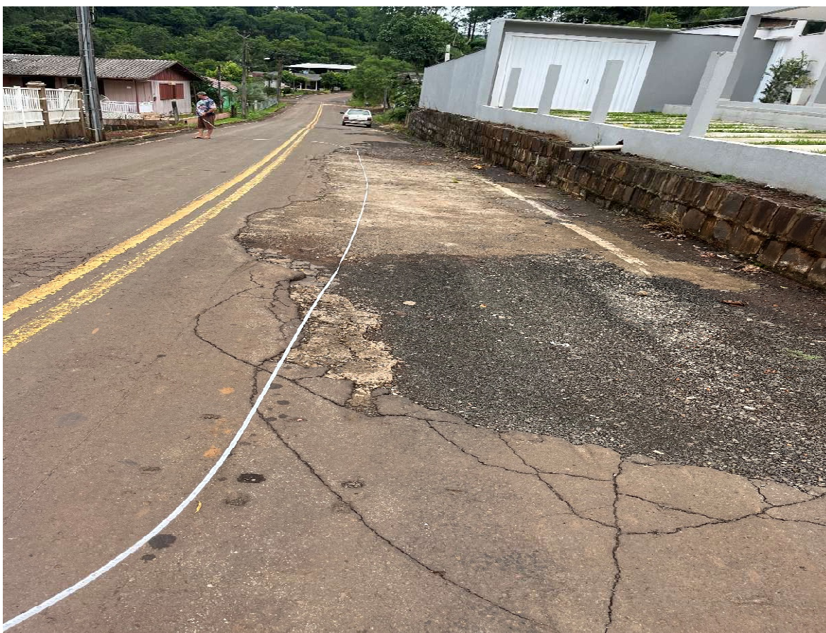
Imagem 11: 19/01/2024 – Buraco 07 Rua Beira Rio
