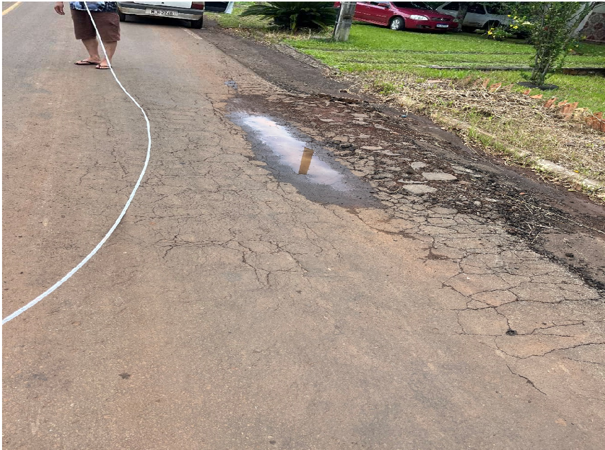
Imagem 08: 19/01/2024 – Buraco 04 Rua Beira Rio
