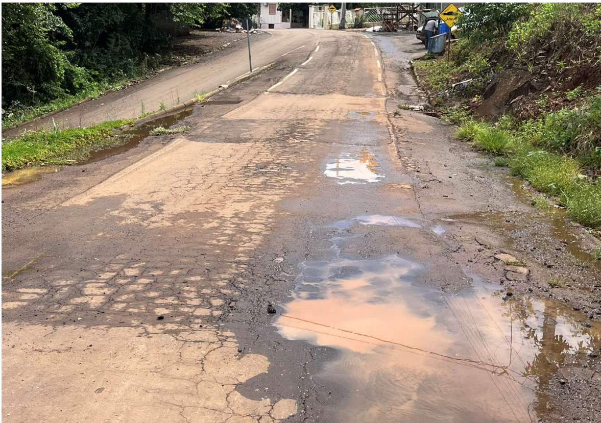
Imagem 07: 19/01/2024 – Buraco 03 Rua Beira Rio
