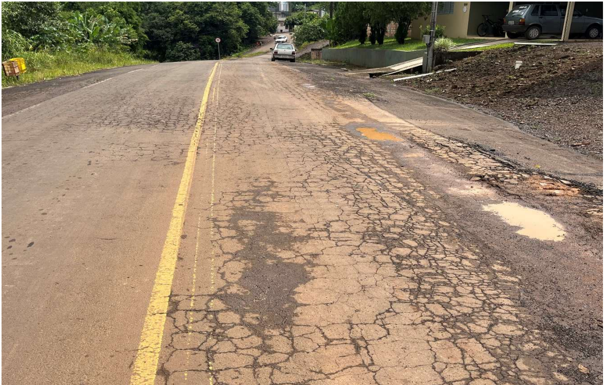
Imagem 03: 19/01/2024 – Buraco 01 Rua Beira Rio
