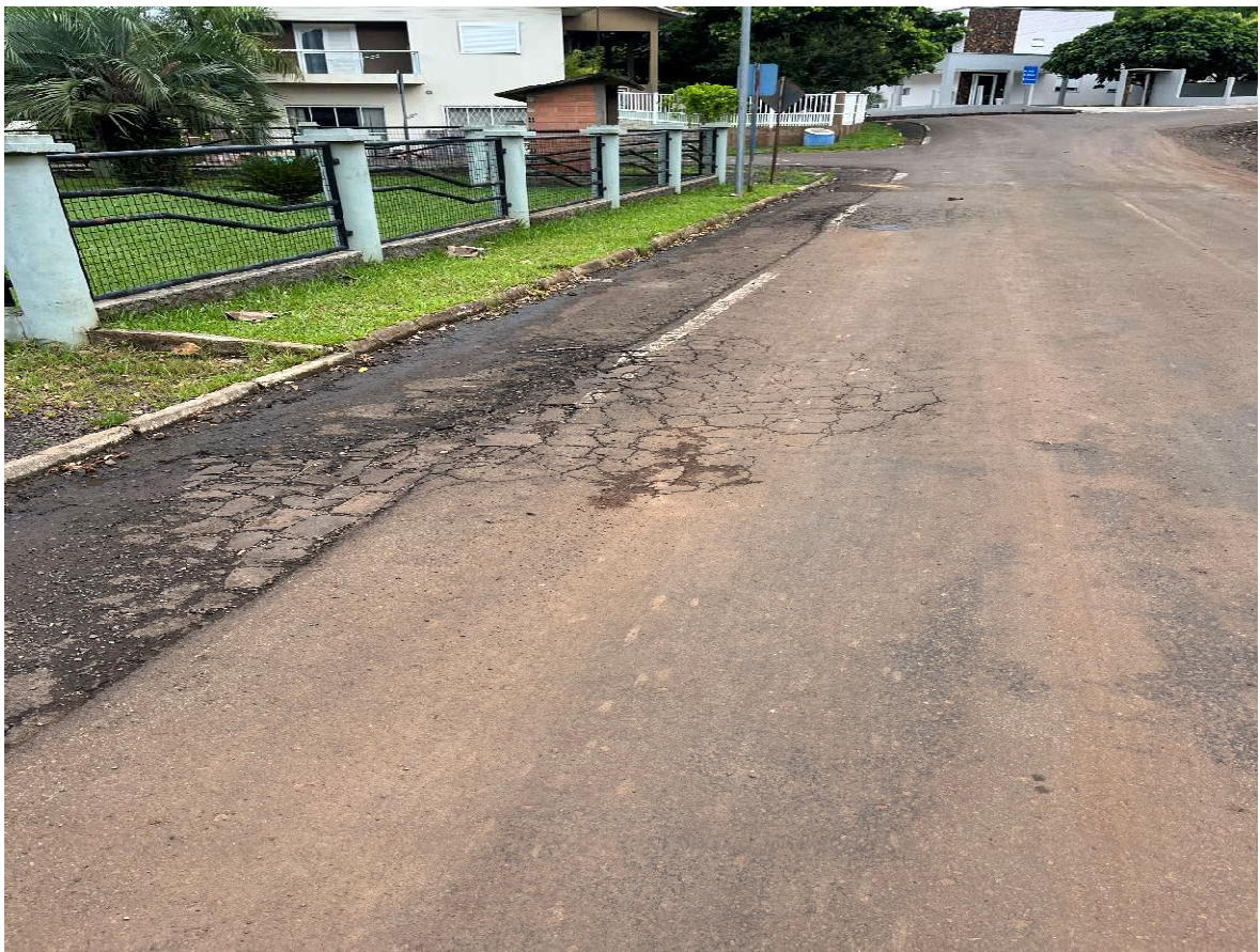
Imagem 09: 19/01/2024 – Buraco 05 Rua Beira Rio
