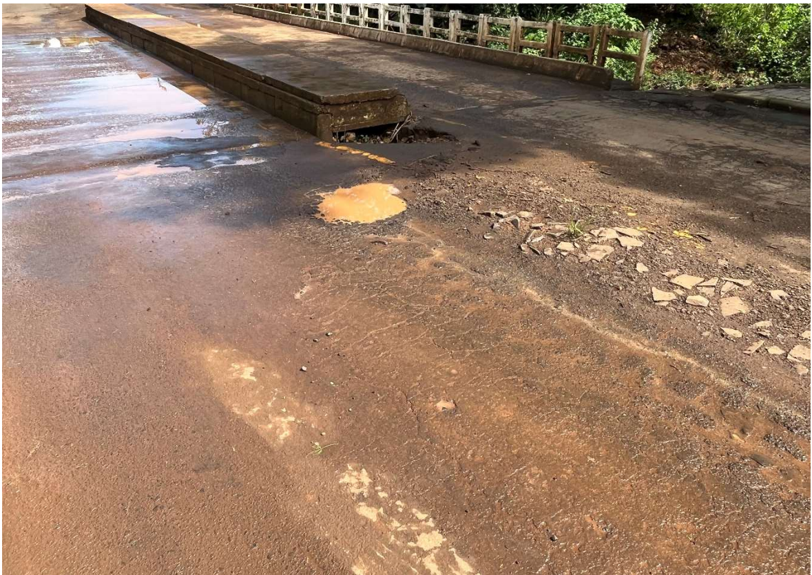
Imagem 24: 19/01/2024 – Buraco 18 Rua Ângelo Toazza
