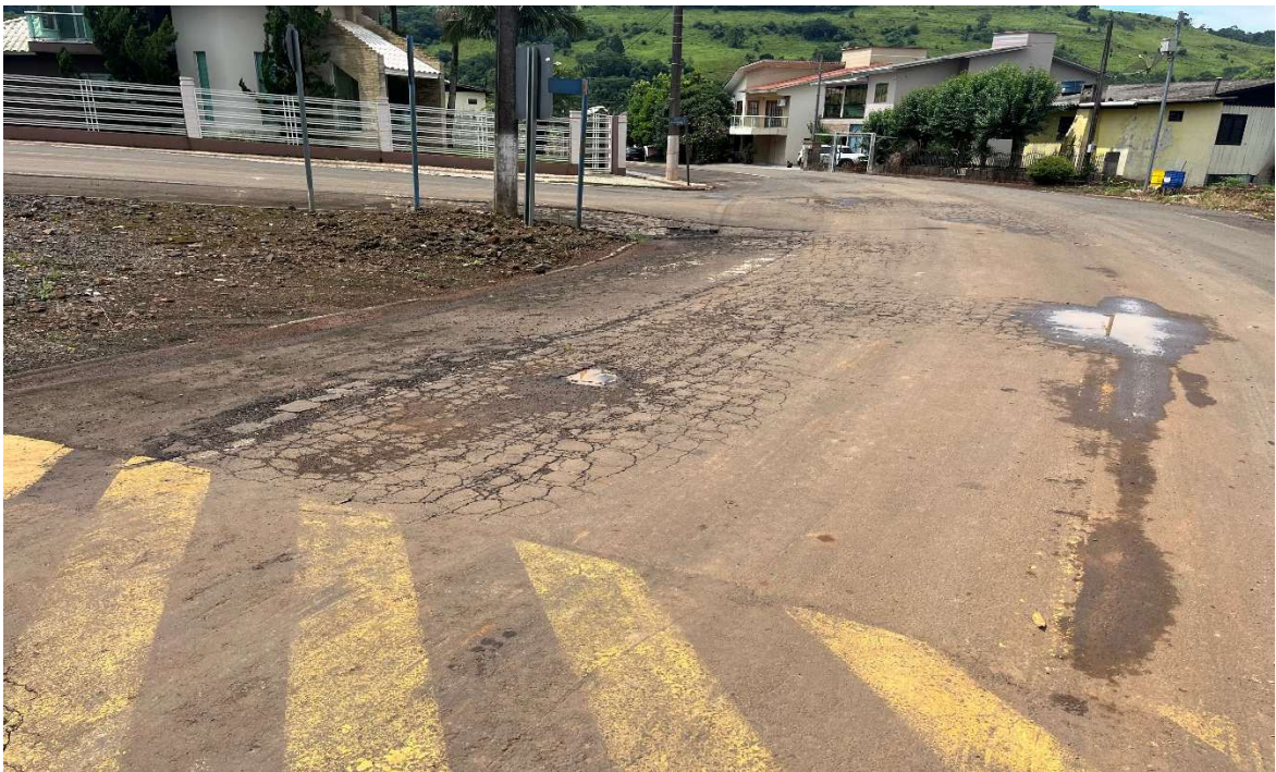
Imagem 01: 19/01/2024 – Buraco 01 Rua Beira Rio
