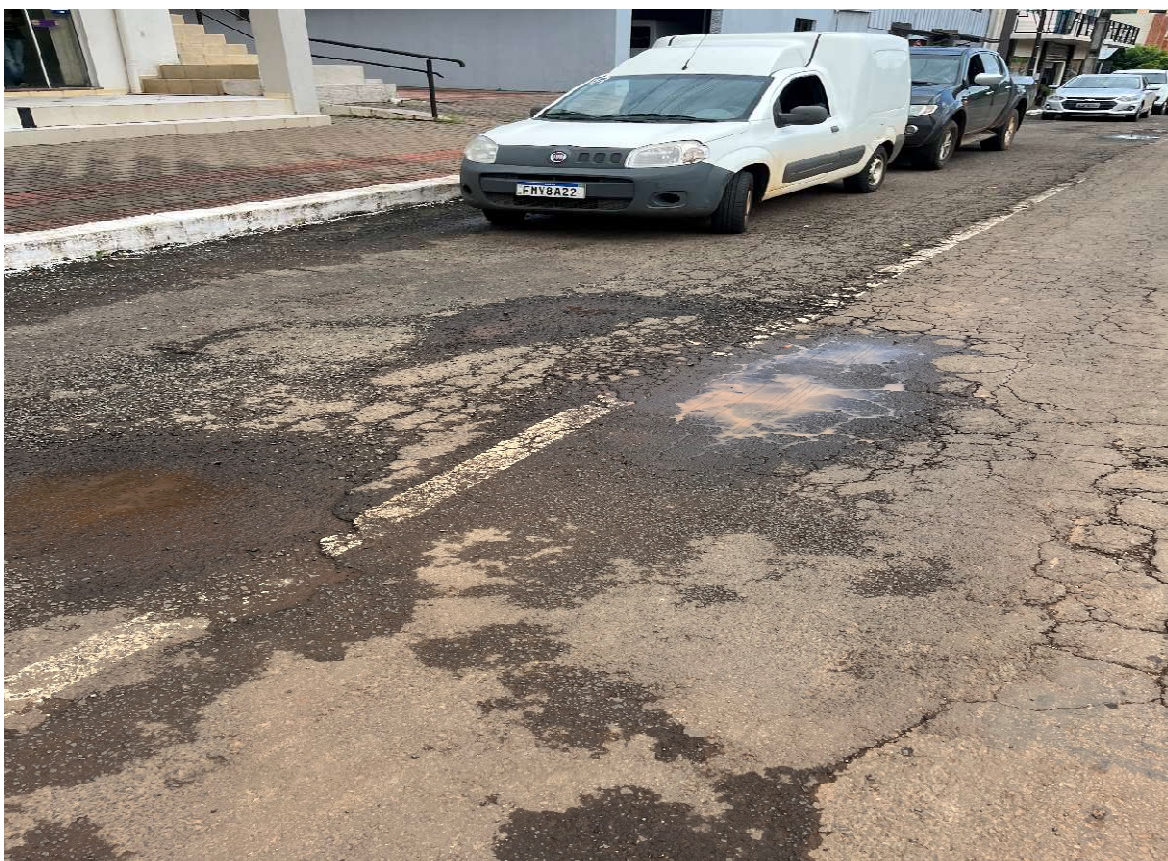
Imagem 17: 19/01/2024 – Buraco 11 Avenida João Corso
