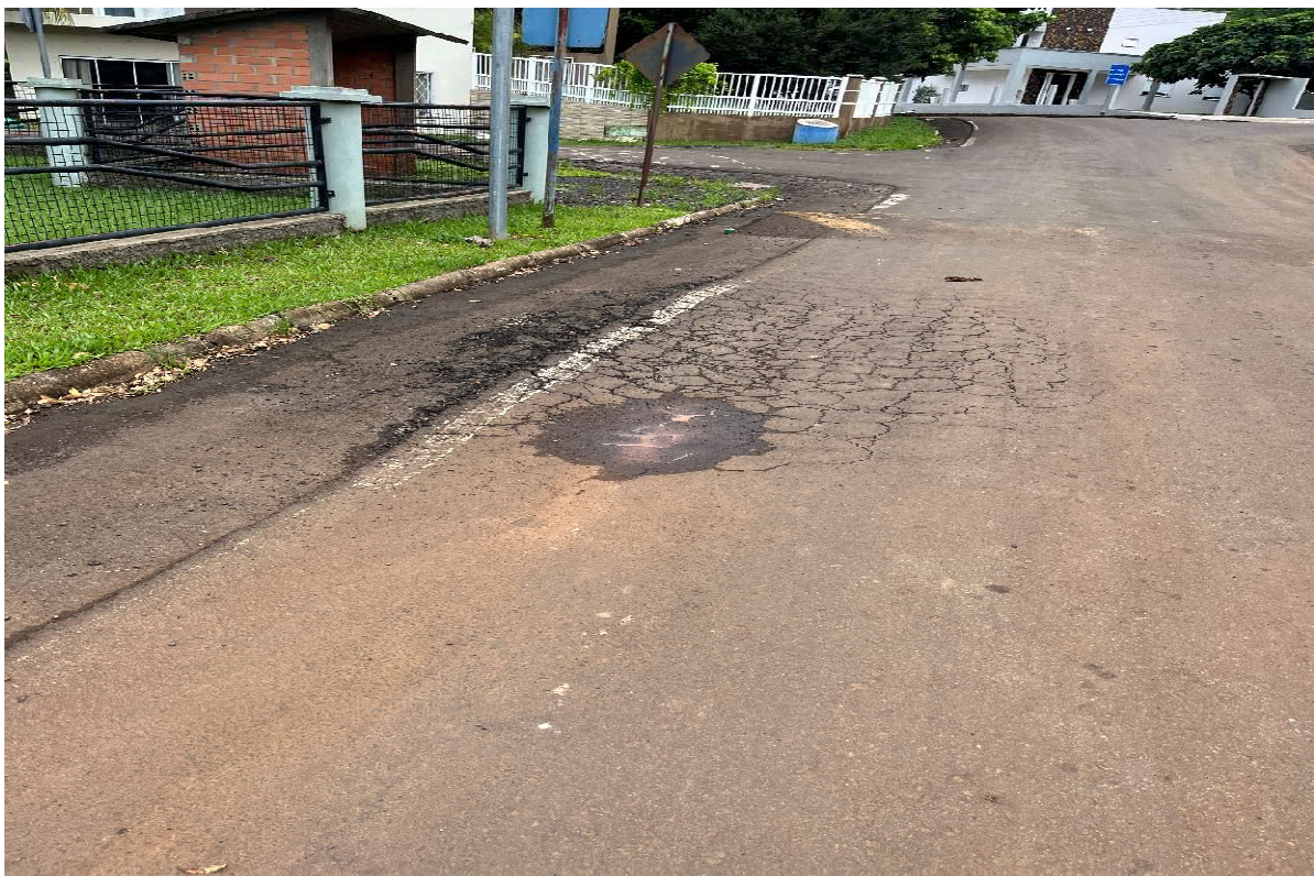
Imagem 10: 19/01/2024 – Buraco 06 Rua Beira Rio
