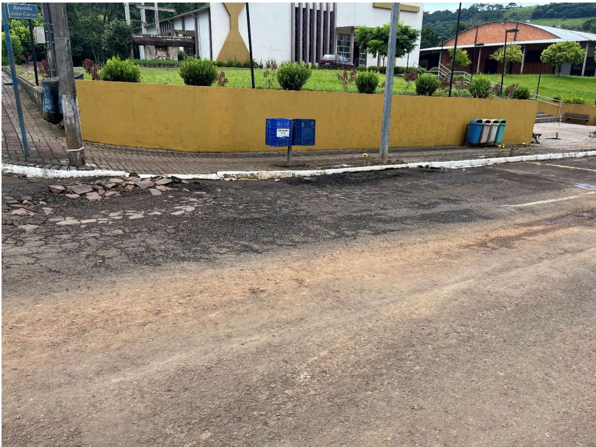
Imagem 15: 19/01/2024 – Buraco 10 Avenida João Corso
