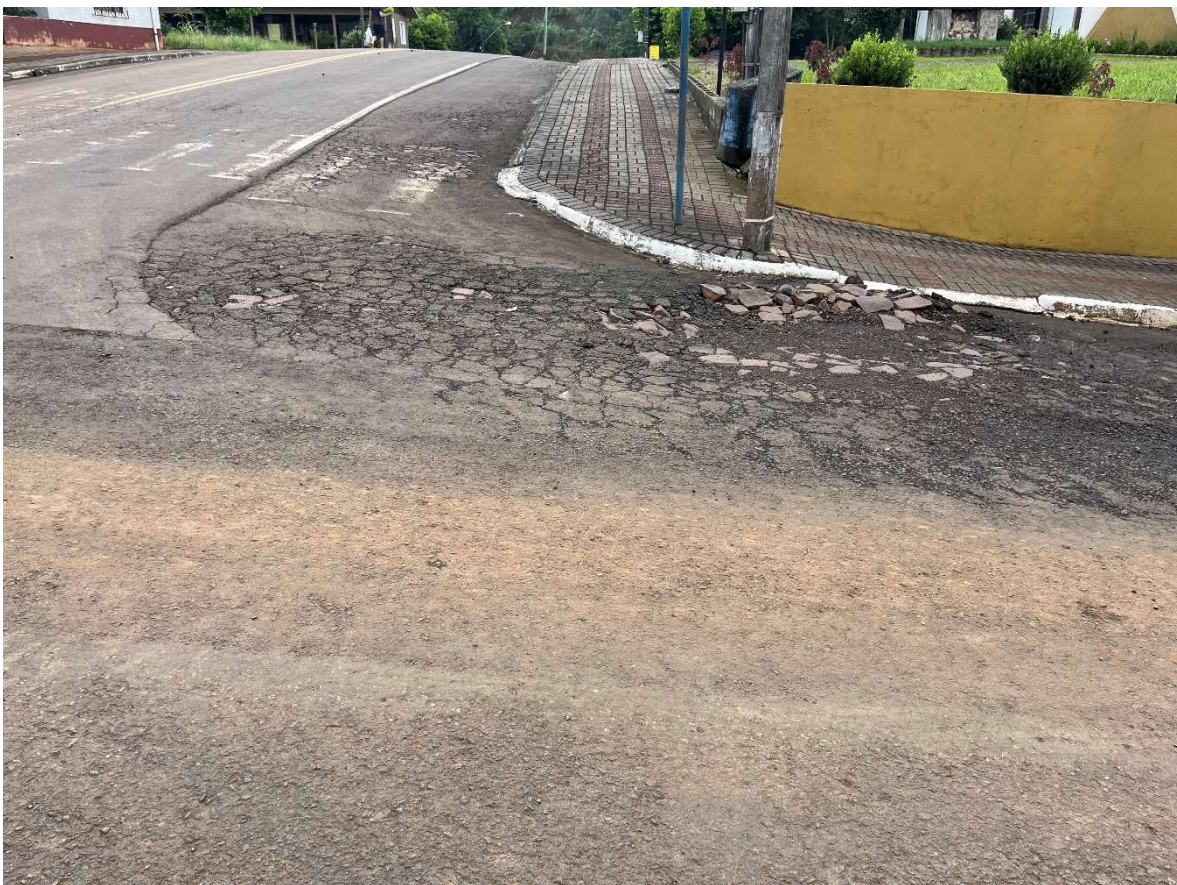
Imagem 14: 19/01/2024 – Buraco 10 Avenida João Corso
