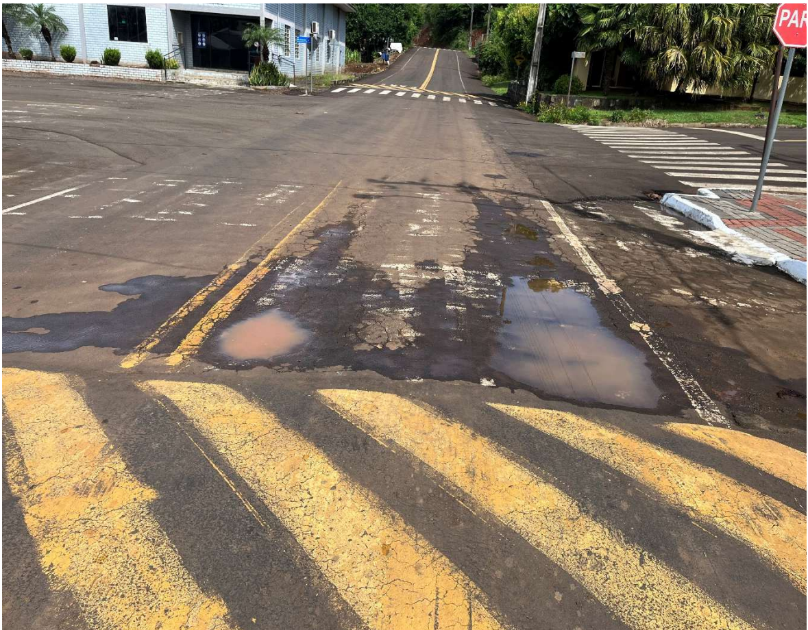
Imagem 22: 19/01/2024 – Buraco 16 Rua Jacob Corso
