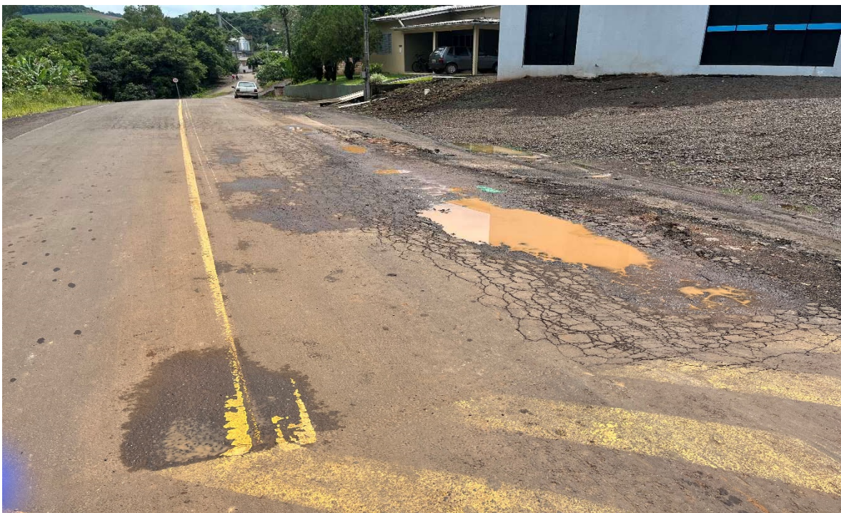
Imagem 02: 19/01/2024 – Buraco 01 Rua Beira Rio
