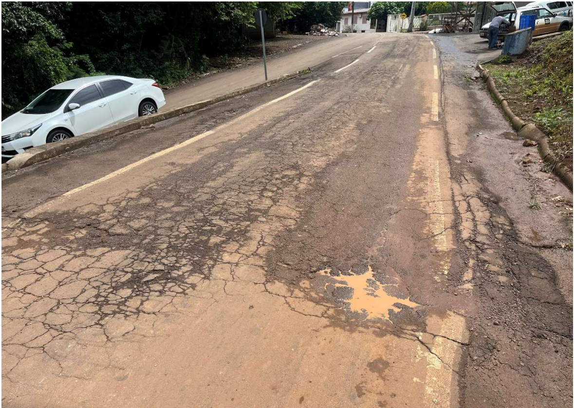
Imagem 06: 19/01/2024 – Buraco 03 Rua Beira Rio
