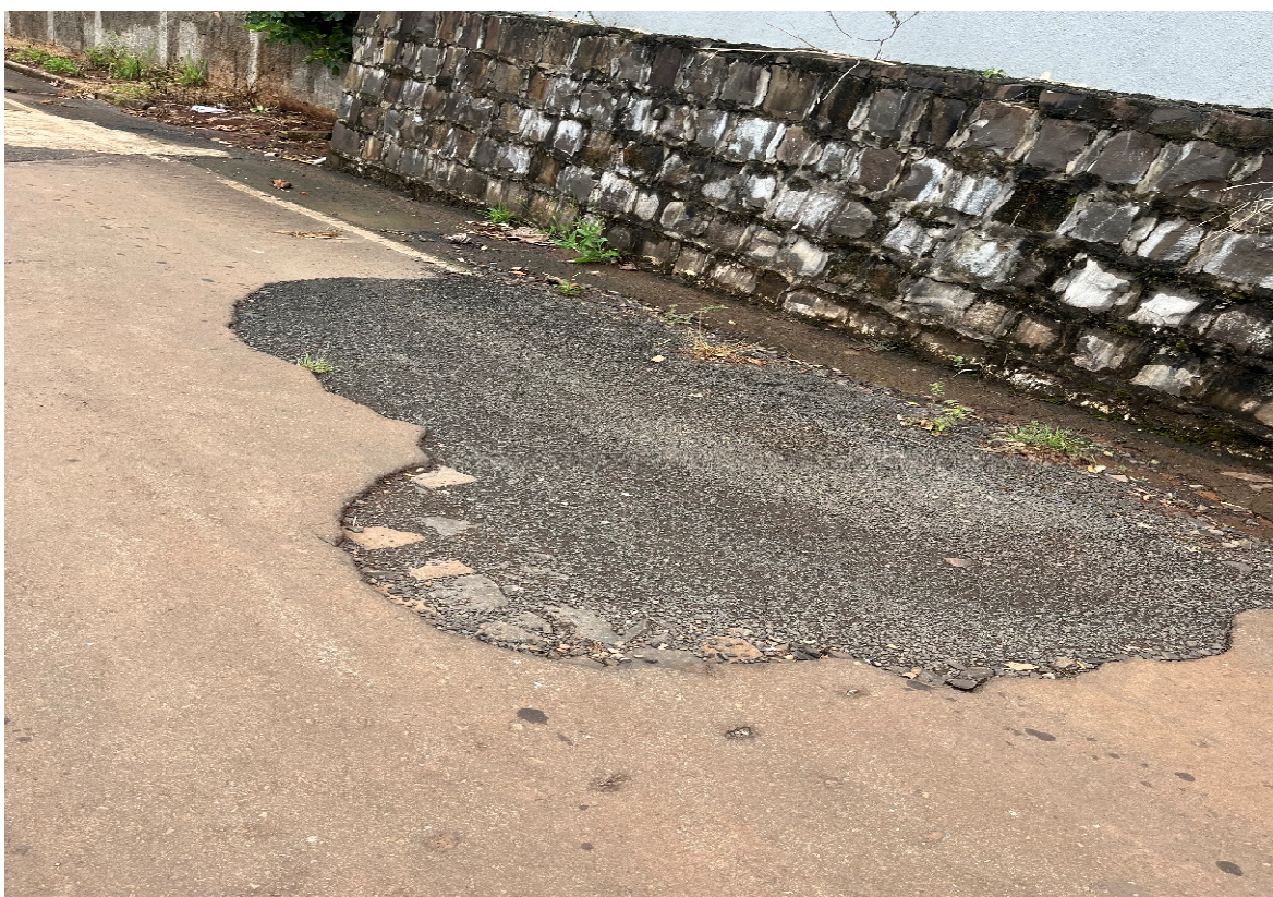
Imagem 12: 19/01/2024 – Buraco 08 Rua Beira Rio
