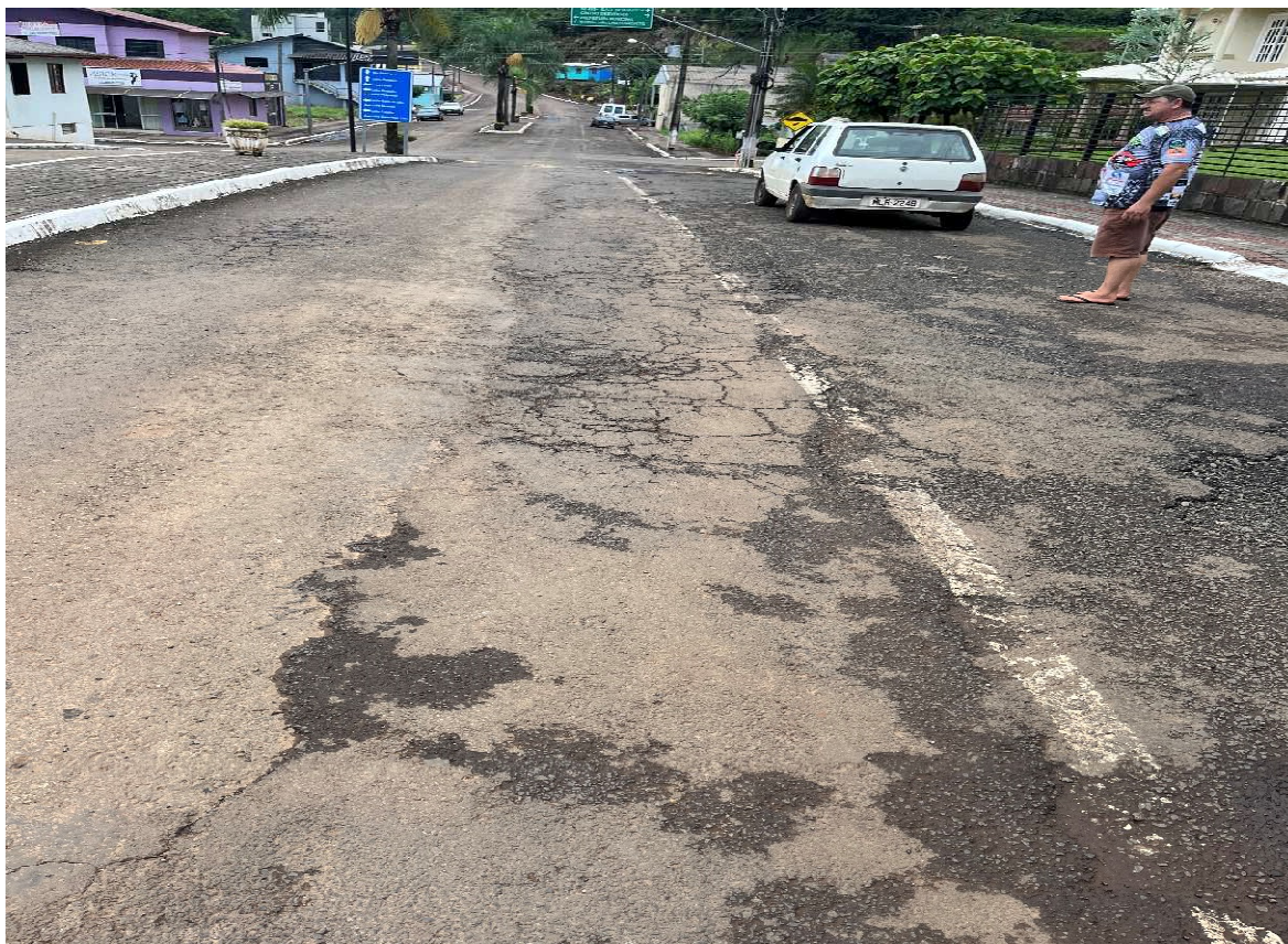
Imagem 18: 19/01/2024 – Buraco 12 Avenida João Corso
