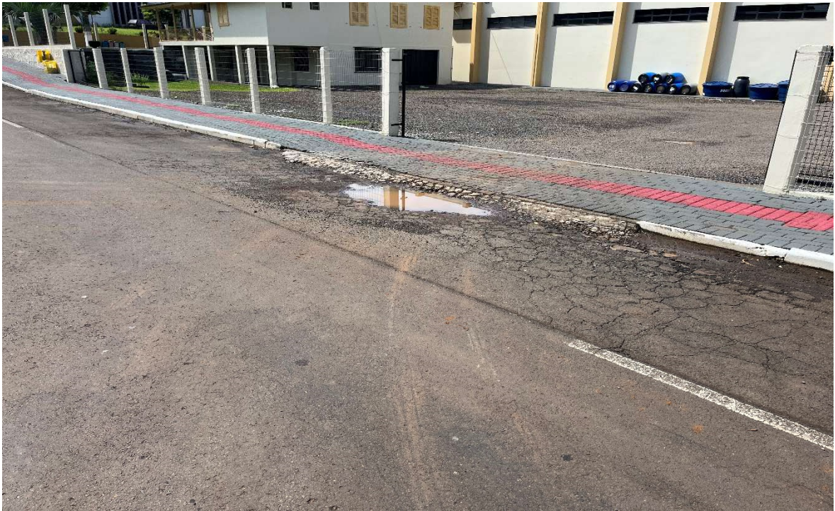
Imagem 21: 19/01/2024 – Buraco 15 Rua Jacob Corso
