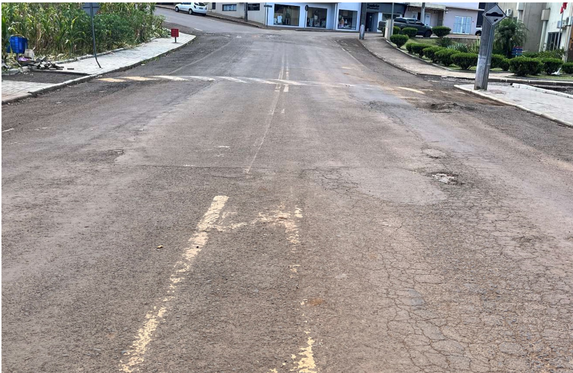
Imagem 25: 19/01/2024 – Buraco 19 Rua Ângelo Toazza
