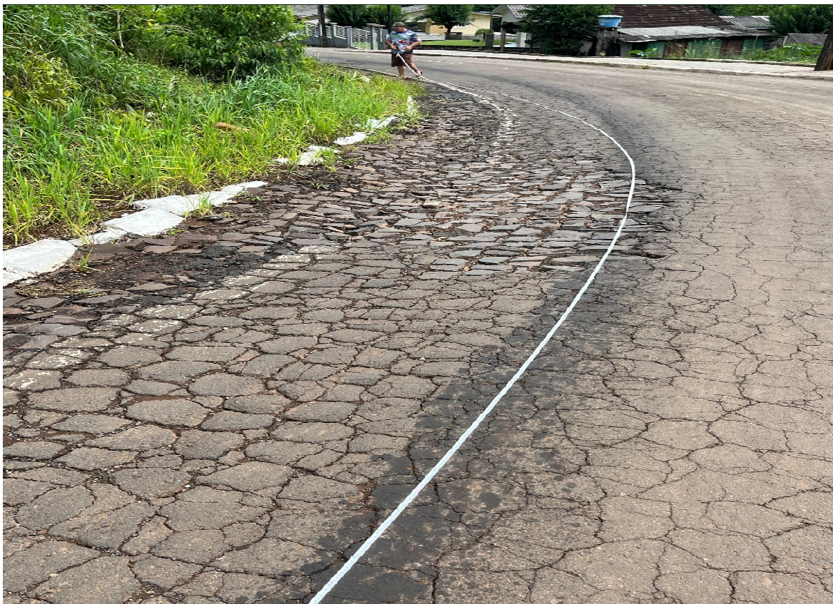
Imagem 20: 19/01/2024 – Buraco 14 Avenida João Corso Saida para São Domingos
