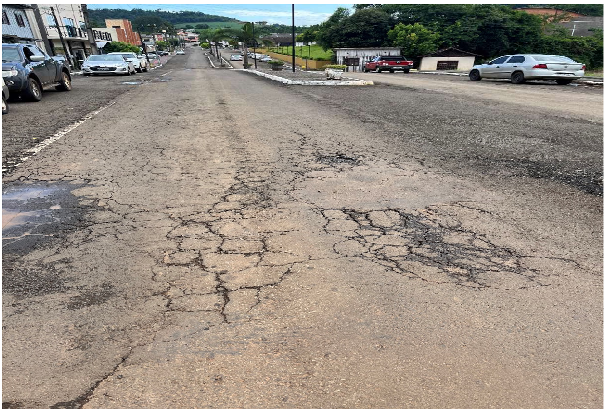
Imagem 16: 19/01/2024 – Buraco 11 Avenida João Corso
