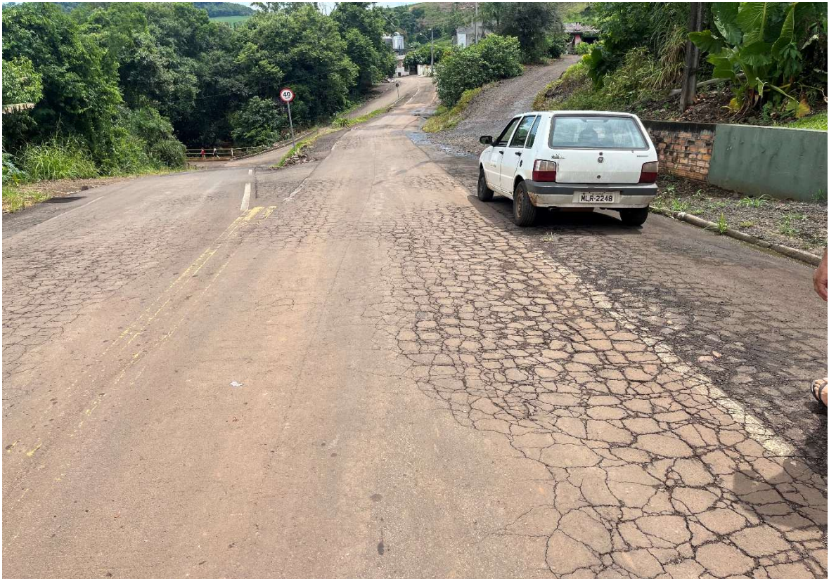
Imagem 04: 19/01/2024 – Buraco 01 Rua Beira Rio
